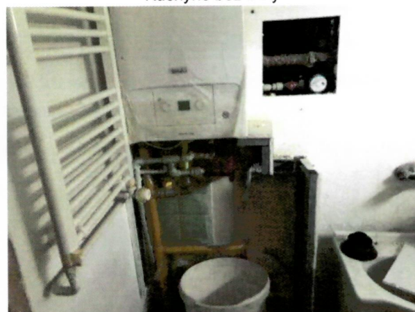
Koupelna, kotel UT
